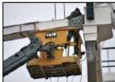
Figura 19. Operario subido sobre las barandillas.
