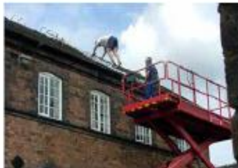
Figura 30. Uso indebido de la PEMP.
