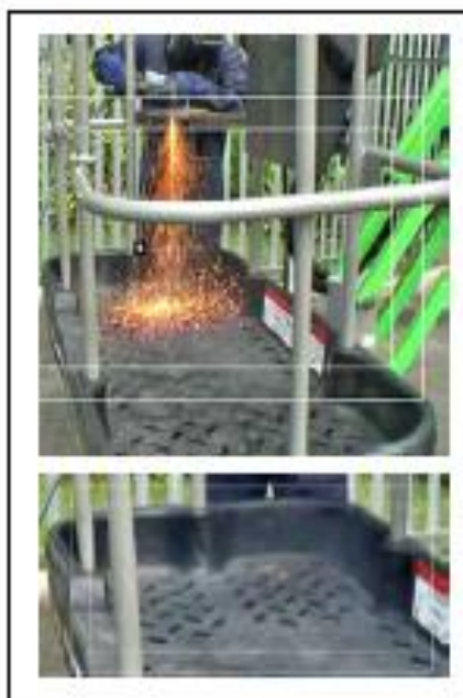
Figura 5. Base de la plataforma de trabajo auto-extinguible.
