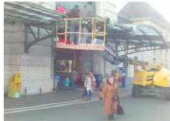
Figura 19. Personas circulando bajo la vertical de una PEMP sin balizar
