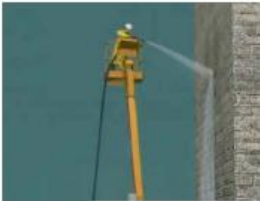
Figura 17. Utilización de manguera a presión con riesgo de superar la fuerza lateral máxima admisible
