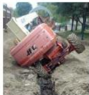
Figura 15. Vuelco por no respetar la distancia de seguridad respecto a una zanja
