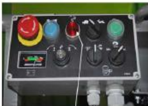
Figura 13. Indicador de alarma de señalización de inclinación máxima.
