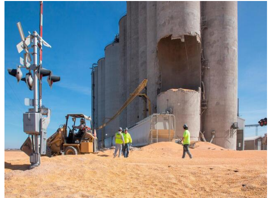
EEUU- Iowa, silo (1970) colapsado en marzo 2022
