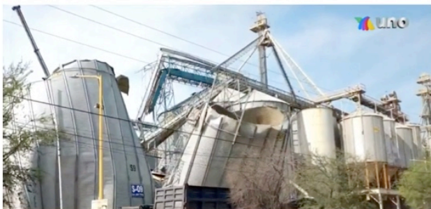
México-Colapso silos en Torreón, Puebla, 3 muertos -16.05.2022
