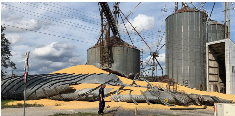
EEUU-Sylvania GA, colapso de silo oxidado, octubre 2019
