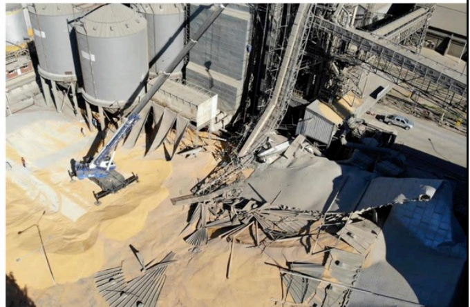
Argentina-Colapso silo en Puerto San Martin (SF), 2 heridos, 02.08.2021.
