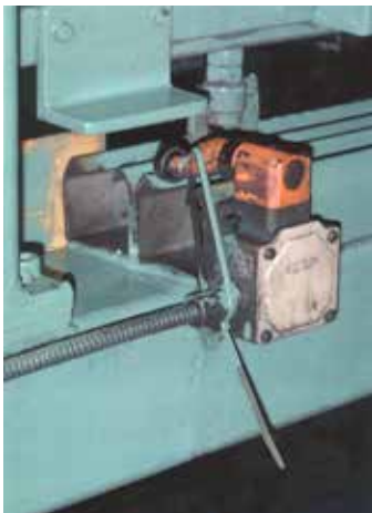
Figura 8. Ejemplo de burlado de un enclavamiento debido a su montaje incorrecto.
