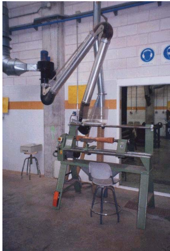
Figura 10. Torno para piezas de madera, provisto de extracción.
