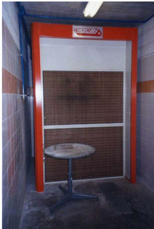
Figura 17. Cabina de pintura
