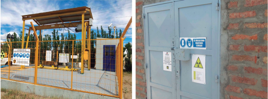
Vista de dos tipos de bunkers en las que se almacenan fuentes selladas y no selladas, en las que pueden observarse las restricciones perimetrales y la cartelería en la que identifica el riesgo radiológico y la obligatoriedad de uso de los elementos de protección personal.
